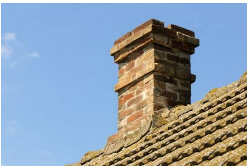
P.J. - Photo de la cheminée endommagée.
